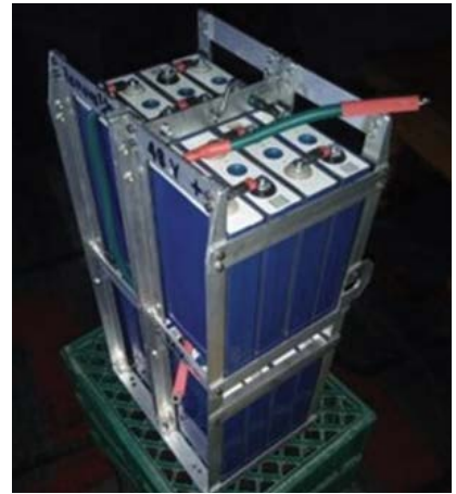
48 volt battery cage
